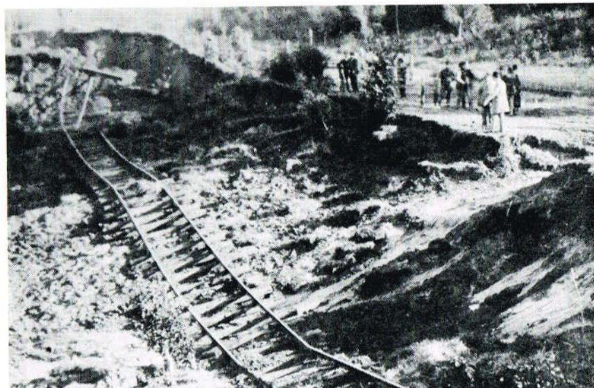
1892 - De spoorwegverzakking op 25 september: de spoordam is weggespoeld over een lengte van 80 m; de rails zijn aan elkaar gebleven.
