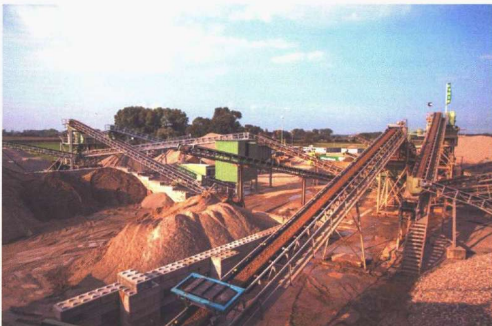
Was-, breek- en zeef-installatie Meers.
